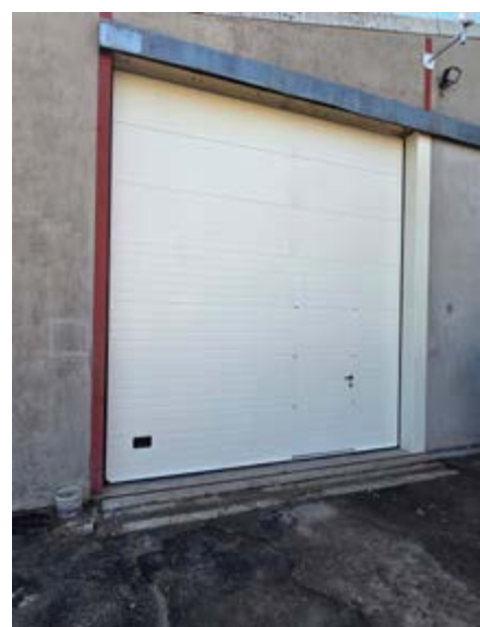
Nouvelle porte sécurisée de centre technique municipal
